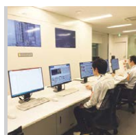
ちゅうおうせいぎよしつ 中央制御室
