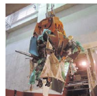
不燃・粗大ごみピット
