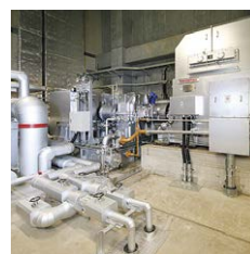
5 蒸気タービン発電機
