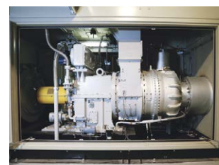
ガスコージェネレーション設備
