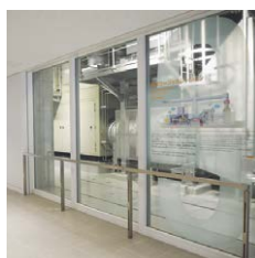
3 ガスコージェネレーション
